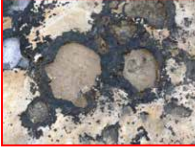
صورة (32) حفر الإذابة المنتشرة فوق أرصفة الشاطئ برأس أبروق
