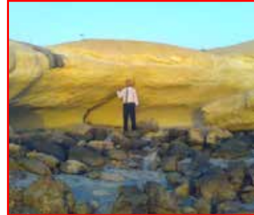
صورة (27) فجوات النحت البحري والأسقف المعلقة بجروف ساحل أبو سمرة، ويلاحظ الكتل الصخرية المتهدلة منها. التصوير: جهة الشرق.
